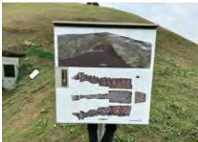
史跡柳瀬二子塚古墳 分電盤 群馬県安中市
