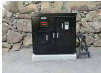
国宝松本城跡 分電盤 長野県松本市
