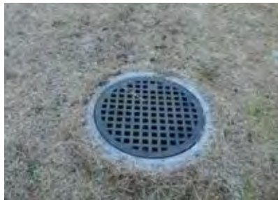
史跡八王子城跡 マンホール 東京都八王子市 給排水設備の事例
