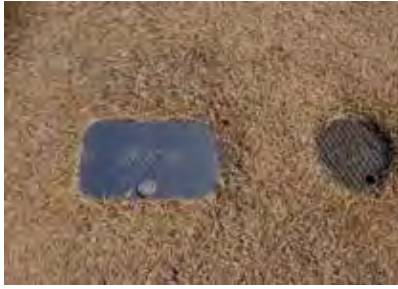
史跡甲府城跡 散水栓・止水弁 山梨県甲府市
