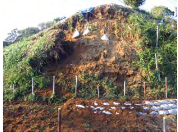
B 平成 21 年 10 月 本丸土塁東側崩落
