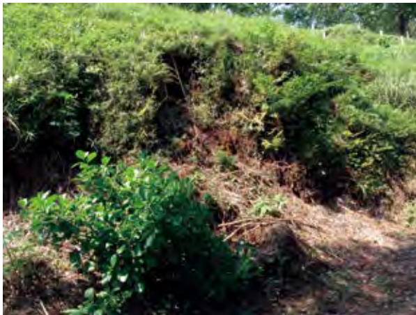
E 平成 24 年 5 月 本丸土塁北側崩落
