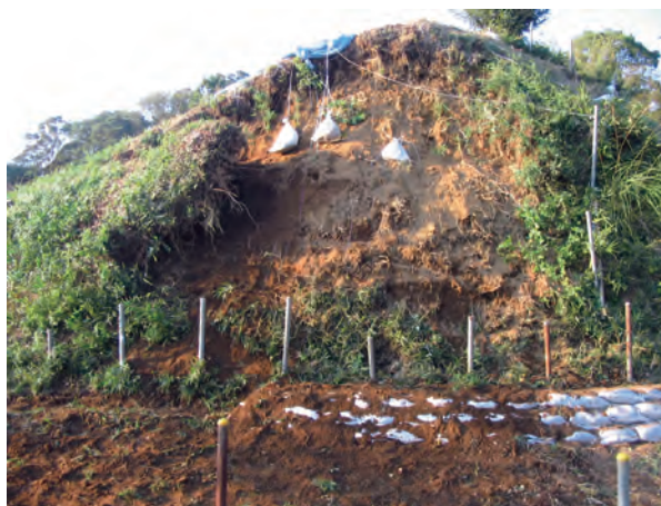
B 平成 21 年 10 月 本丸土塁東側崩落
