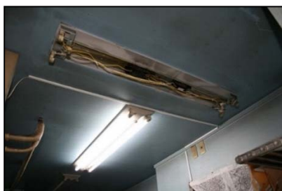
(参考)照明器具からの火災
