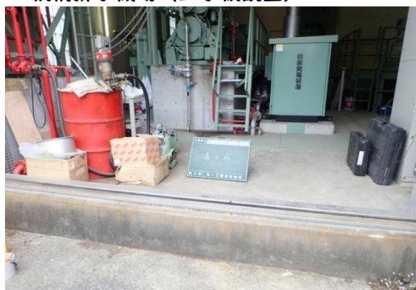
三枚橋排水機場（止水板設置）
