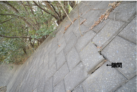
擁壁の危険度判定評価
