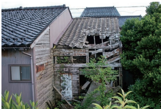
屋根が崩落した空家等
