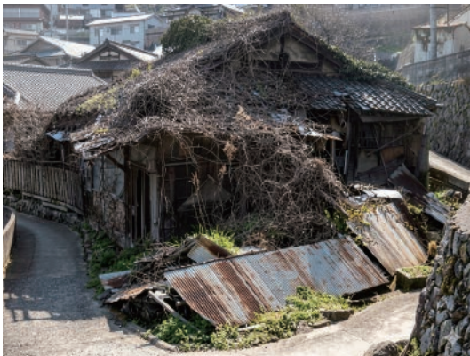
特定空き家等 老朽化が進み、倒壊等の危険性大
