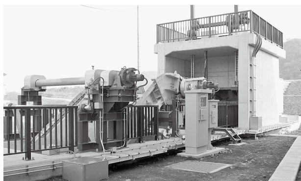
▲大雨等による浸水被害軽減のため、市街地等にたまった雨水をポンプで強制的に河川に排出する排水機場
