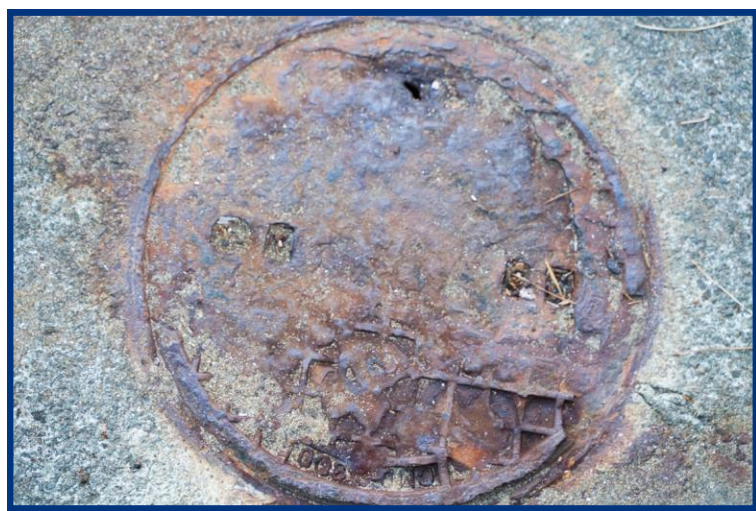
老朽化したマンホール鉄蓋
