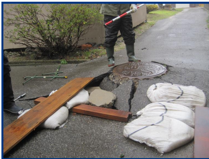
浮上したマンホール(能登半島地震)
