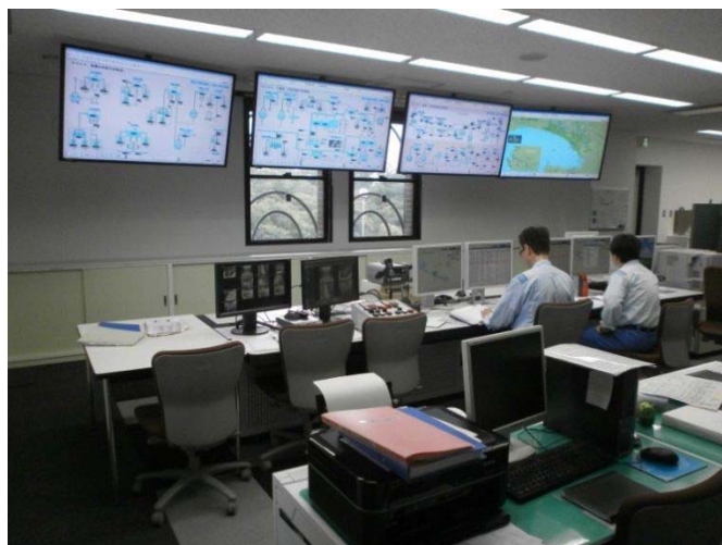
送水管理センター 中央管理制御室
