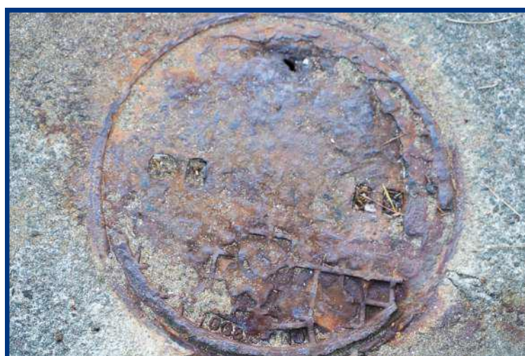
老朽化したマンホール鉄蓋
