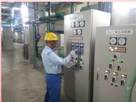
運転状況の確認
