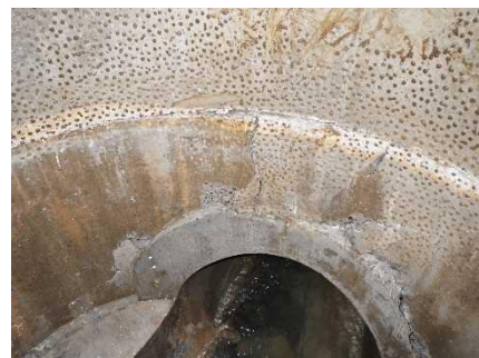
■地震により破損した管口
