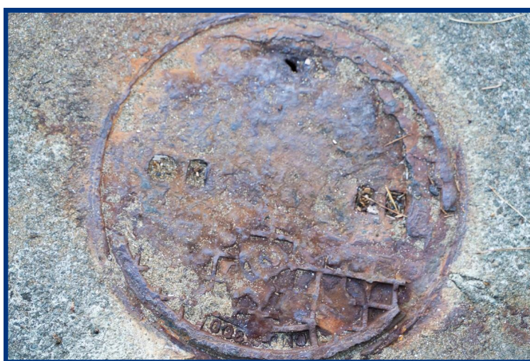
老朽化したマンホール鉄蓋
