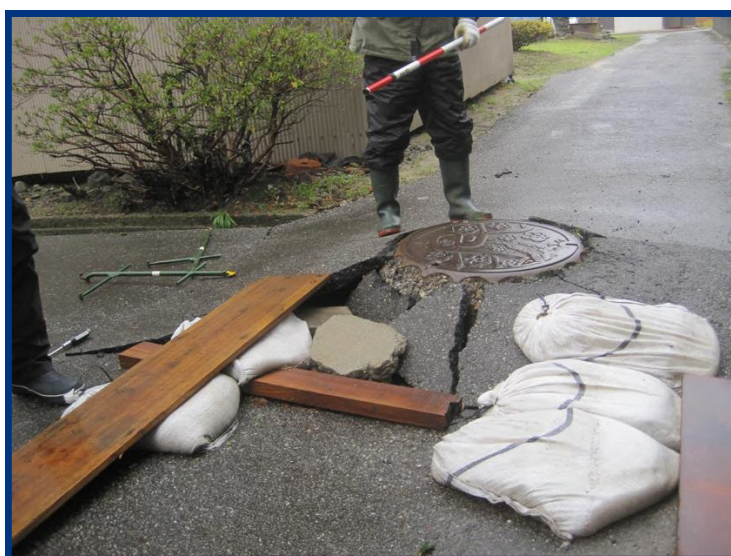
浮上したマンホール(能登半島地震)
