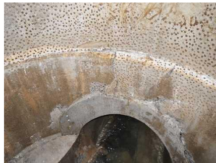
■地震により破損した管口
