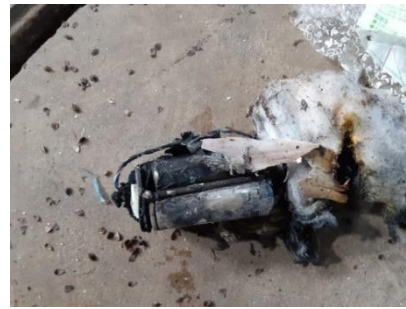
発火原因となったバッテリー (令和6年5月)
