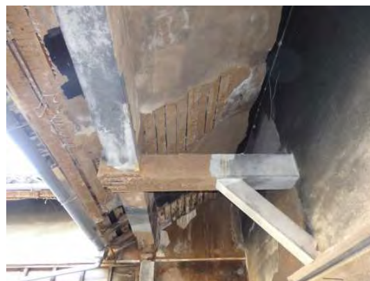
写真 4-1-1-1 主屋東下屋軒裏 漆喰塗崩落状況
