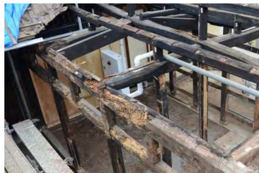
写真 4-1-1-2 主屋釜屋 桁及び差鴨居腐朽状況
