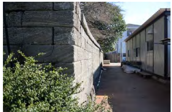
写真 4-1-1-7 南塀 傾斜及び波打ち状況
