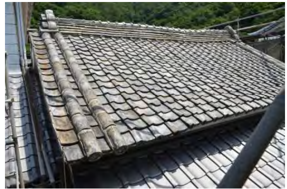
写真 4-1-1-3 ミセ南面 大屋根大棟不陸状況
