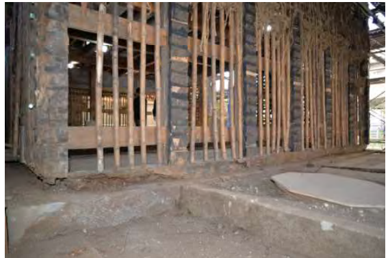
写真 4-1-1-5 東土蔵北面 土台腐朽状況
