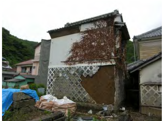
写真 4-1-1-4 文庫蔵西面 海鼠壁及び軒蛇腹崩落状況
