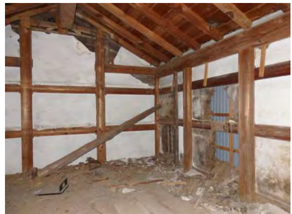
写真 4-1-1-6 北土蔵 2 階西半北面及び西面 漆喰壁崩落状況
