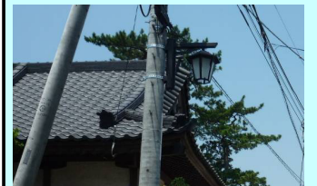
白隠のみち整備事業 街灯
